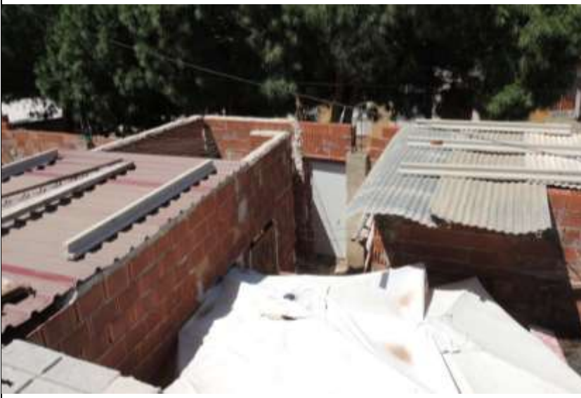
Construcciones precarias en la parte baja de la ladera
