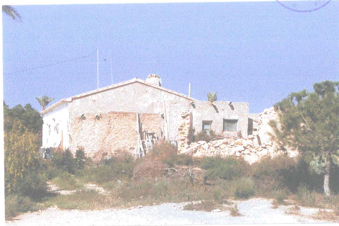
VIVIENDA EN MAL ESTADO, PROPIEDAD DE LOS HNOS. CANOVAS MOLINA PARCELA 49 - POLIGONO 14
