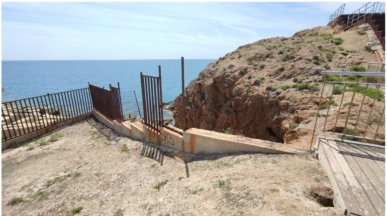
Img. 06 – El vallado perimetral actual presenta serias deficiencias en su recorrido, pudiendo suponer un peligro para los usuarios del mirador y los asistentes a los eventos.
